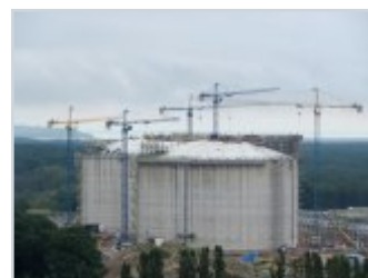
TERMINAL LNG W ŚWINOUJŚCIU
